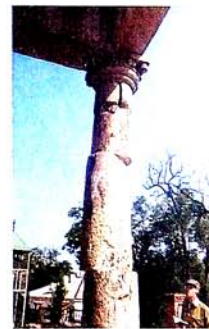
1927-ci ildə baş vermiş 7 ballıq zəlzələ zamanı On İki Apostol (Balaklava) kilsəsinin sütununda baş verən yerdəyişmə.
