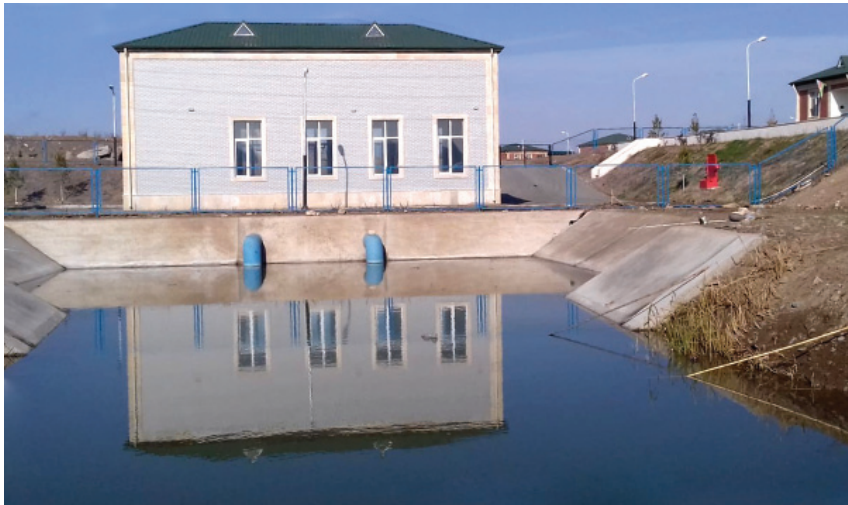
Şəkil 4.7. Suvarma məqsədli nasos stansiyası (Cocuq Mərcanlı kəndi)
